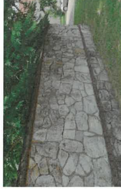
Abb. 34: Bruchsteinmauer mit Klinkerreihe oberhalb des Sockels und abge-schrägten Schiefers als Mauerabdeckung. Foto, Juni 2020 (bankert&menn)
